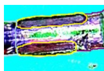
▲ 压接区域损伤
